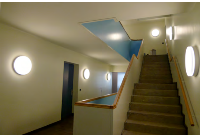
Leuchten im Treppenhaus
