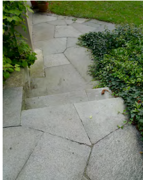
Fehlende Bezeichnung der Stufenvorderkanten und fehlende Handläufe
