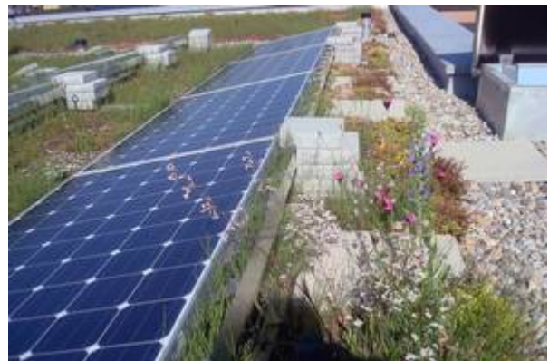
Nachträglich erstellte Fotovoltaikanlage
