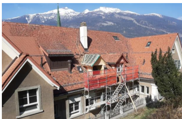
Behutsamer Umbau mit Rücksicht auf die wertvolle Bausubstanz: Ergänzung einer zweiten Lukarne.
