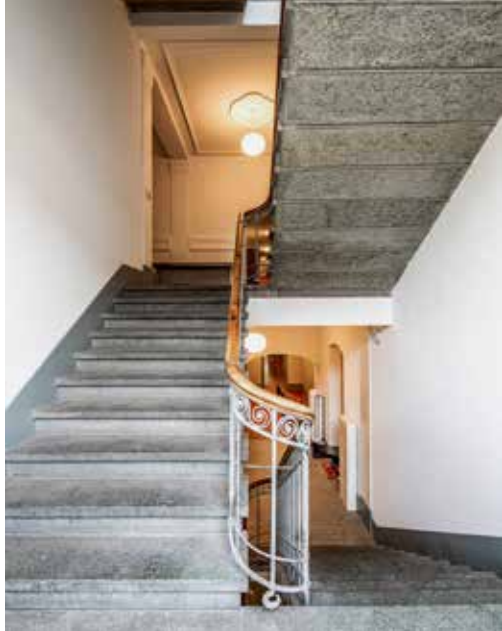
Die geschützten Treppen und Gänge mussten in ihrer Grundstruktur erhalten bleiben und wurden denkmalpflegerisch saniert.
